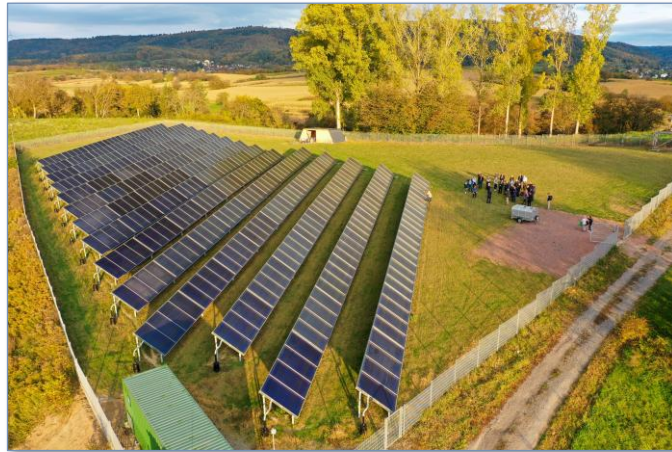
Fernwärme Ettenheim Source: Peter Blaser
