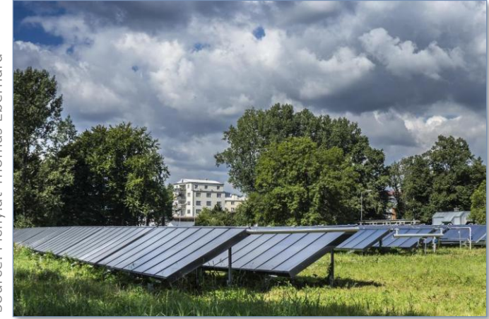
Fernheizwerk Graz (FHW) Source: Picfly.at Thomas Eberhard
